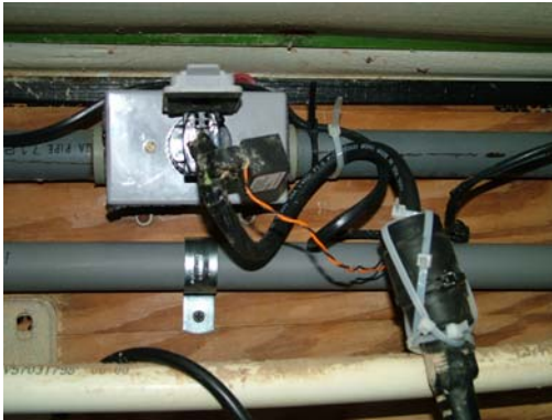
Fan runtime sensor
